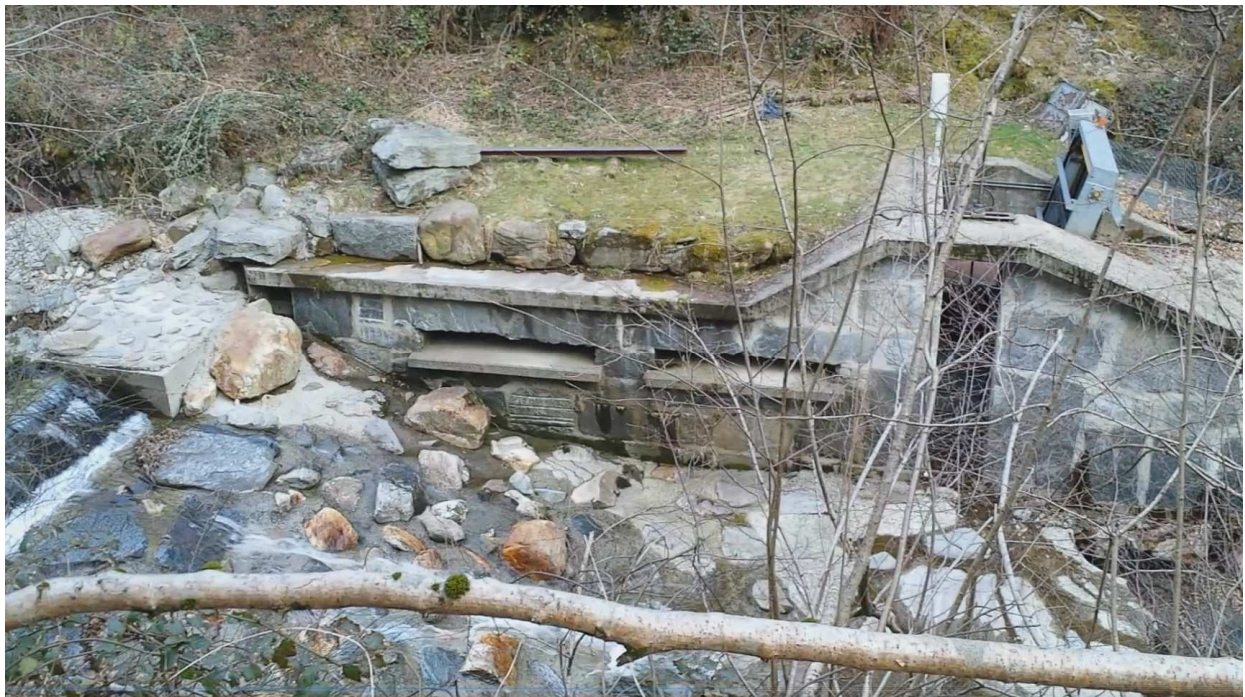
Figura 12. Sito di "Scareno". Dissabbiatore e vasca di carico. Sono visibili gli sfioratori laterali e la paratoia per la regolazione ed il controllo delle portate.
